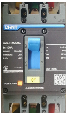
图3.1-1下电箱塑壳断路器（合闸状态）
